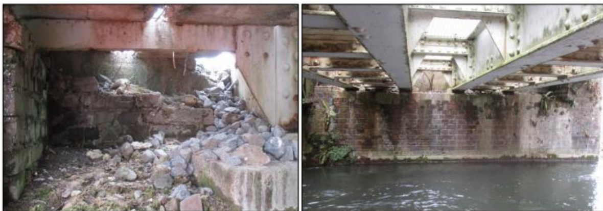
Figure 5 : Ligne 325 000 – PRA pk 144+887 – Photographies des désordres sur l'ouvrage
